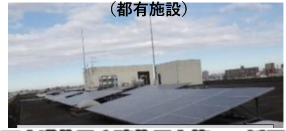
下水道施設や建物屋上等への活用
