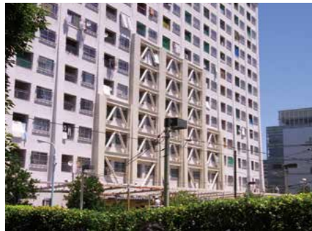
外付け耐震ブレース
